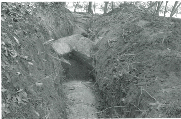
3 北部舗石上の崩落石 (12-26)
