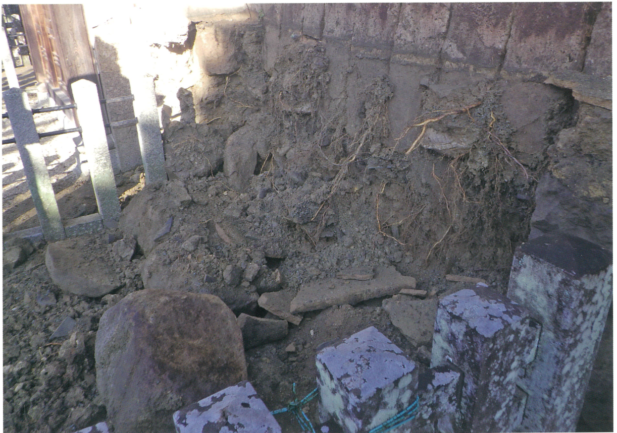
2 東区 石積崩落状況（南東から）
