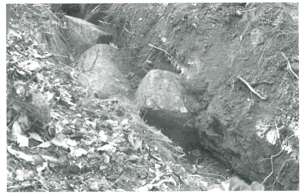
6 北部舗石 上 崩落石 (12-29)
