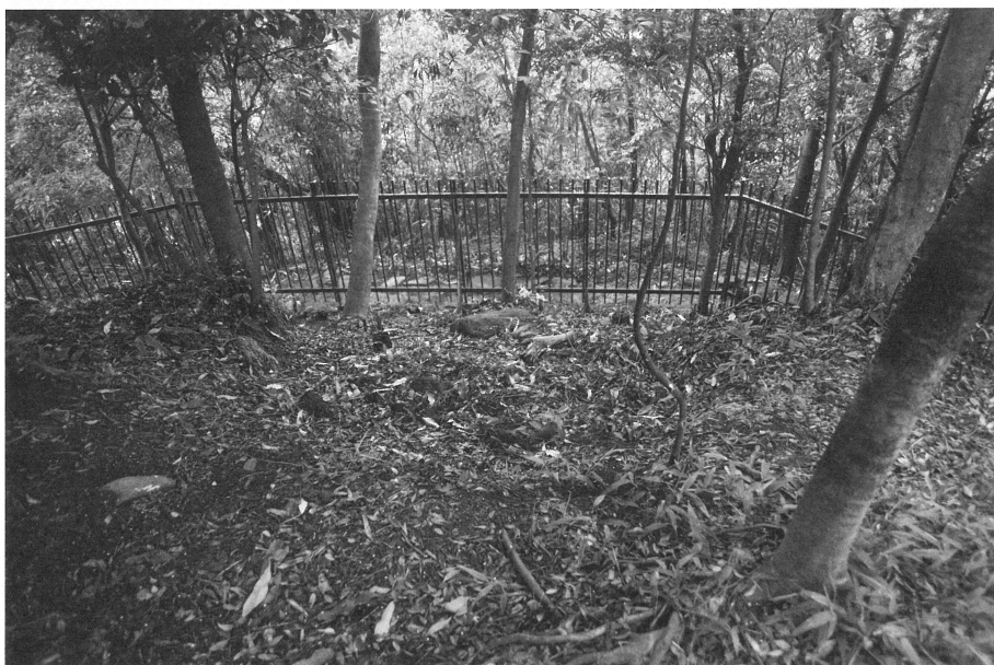
2 墳丘東側崩落箇所 (西から)
